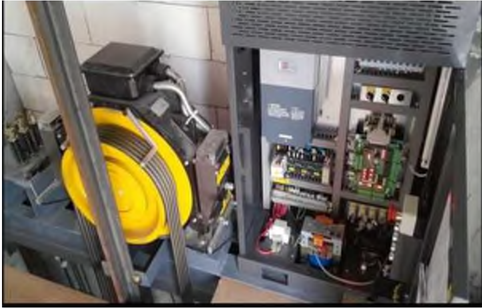
Hình 4. 5. Tủ điều khiển động cơ thang máy
