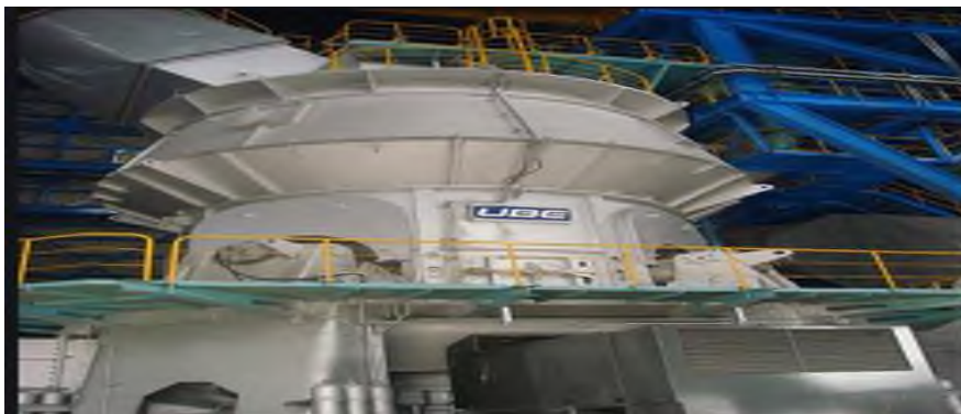
Hình 3. 10. Máy xay đá trong nhà máy xi măng
