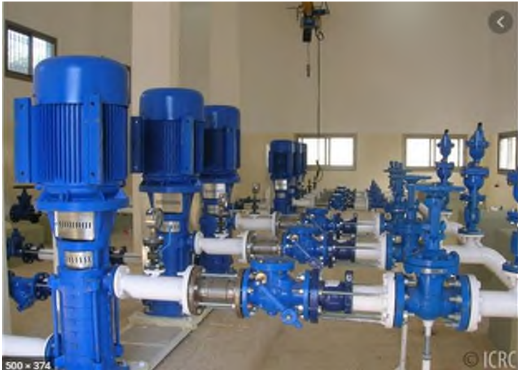
Hình 4.10. Trạm bơm nước công suất lớn
