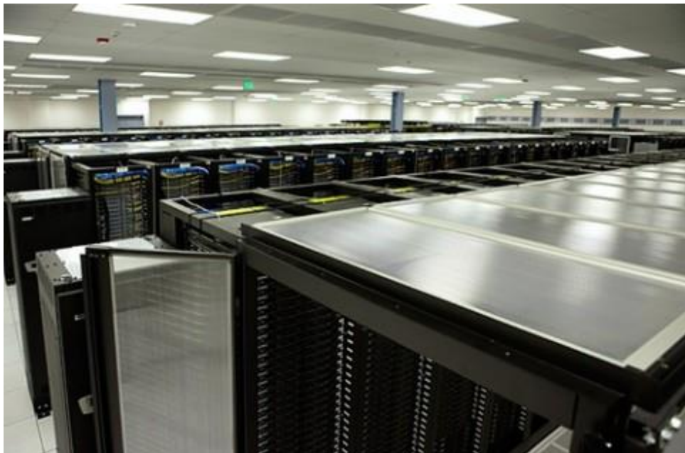
Hình 5.3: Datacenter của Viettel IDC Sóng Thần – Bình Dương
