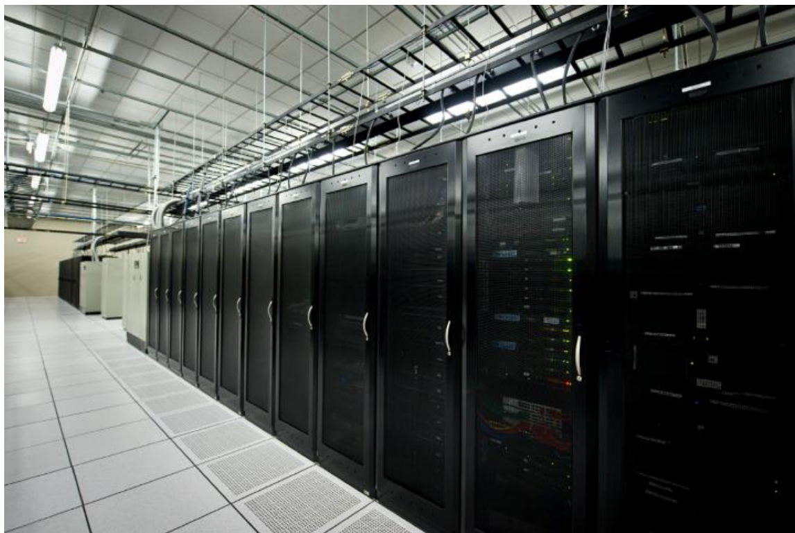
Bên trong một Datacenter tại Dallas, Texas. Mỹ
